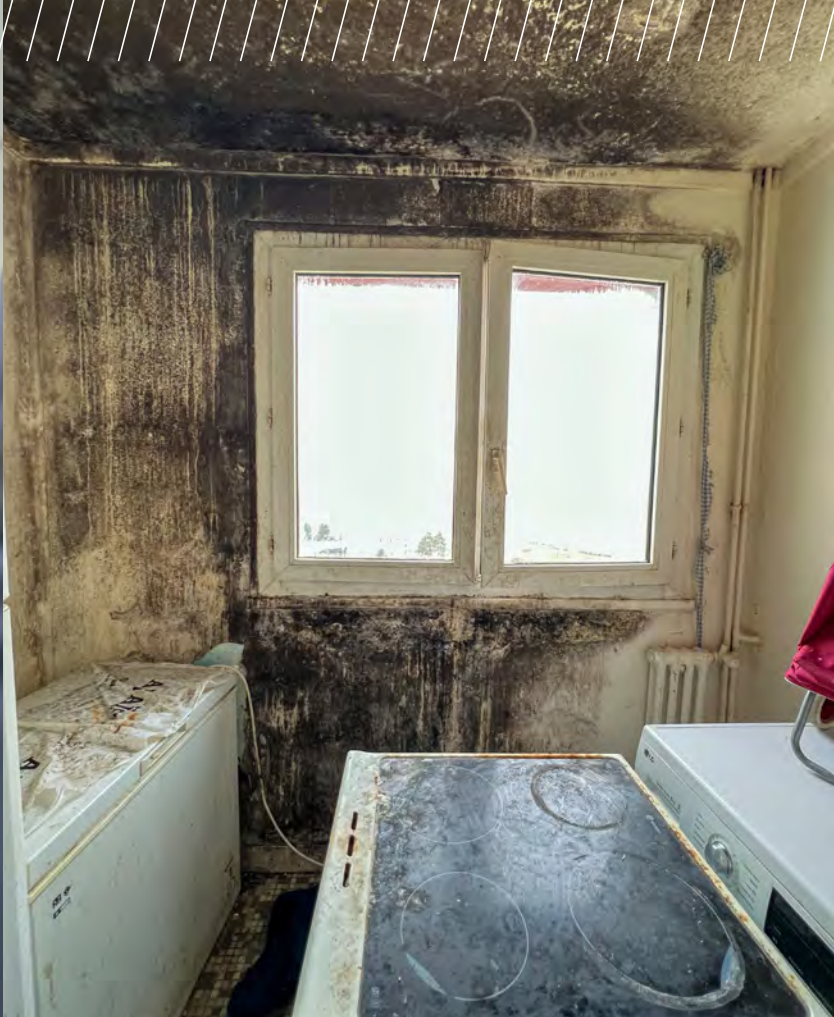
L'intérieur des appartements insalubres cité Pagel à l'Île-Saint-Denis.
